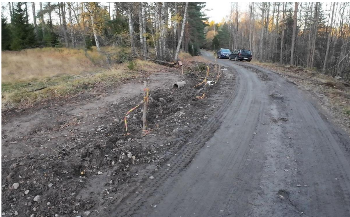
BILD 11 KORSUDDSVÄGEN: OTUR MED EN SKOGSMASKIN PÅ 76 TON SOM KÖRDE I DIKET ÖVER FIBERKABELN - TUR ATT DEN HÖLL, KABELN.
